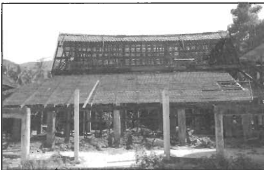
อาคารมัสยิดเก่าอายุกว่า 300 ปี ในหมู่ 4 บ้านควนลังงา กรมศิลปากรได้ขึ้นทะเบียนเป็นโบราณสถานและอยู่ในระหว่างการบูรณะ
